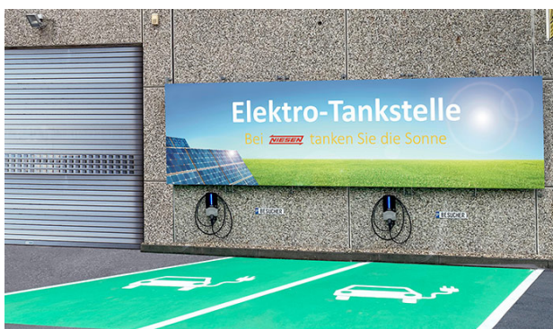
Elektro-Tankstelle bei DMS Niesen
