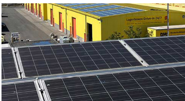
Solardach auf den Hallen von DMS Friedrich Friedrich
